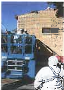
Málaga, 2017. Retirada de amianto del Colegio José Calderín. Asbestos Removal from a College.
